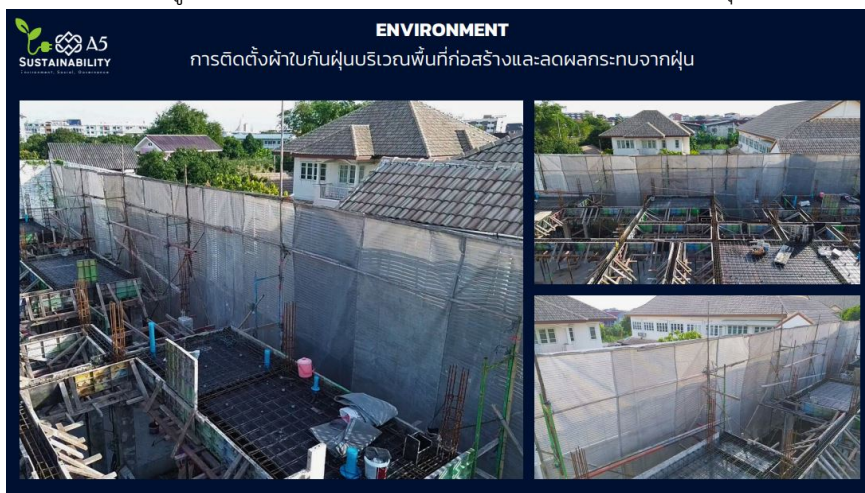
การติดตั้งผ้าใบกันฝุ่นบริเวณพื้นที่ก่อสร้างและลดผลกระทบจากฝุ่น
